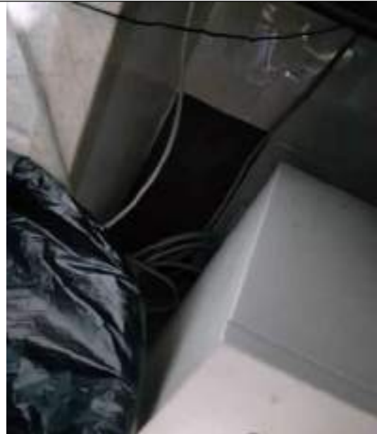
电缆穿线孔铅皮遮挡
