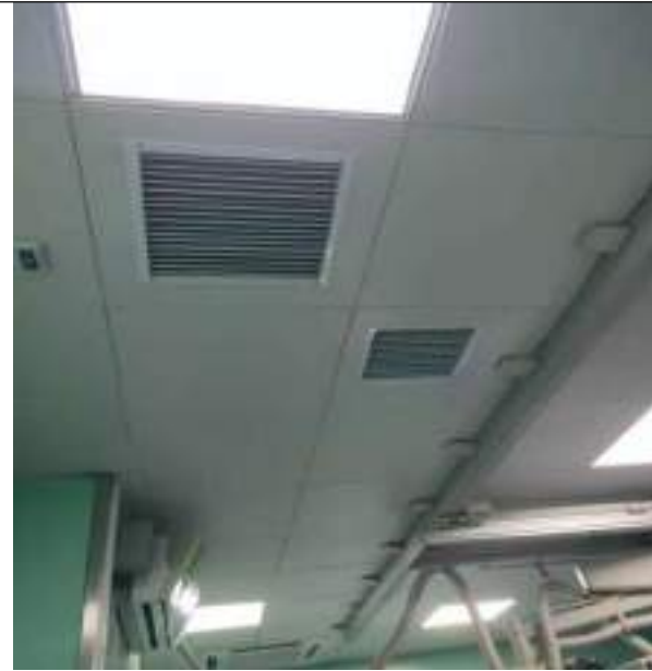
DSA 机房设置的进风口、排风口
