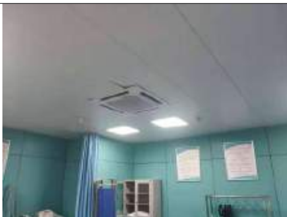
64 排 CT 机房通风设施
